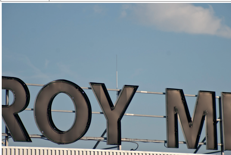
Мачта с изолированным молниеотводом - защита вывески Leroy Merlin Краков.
